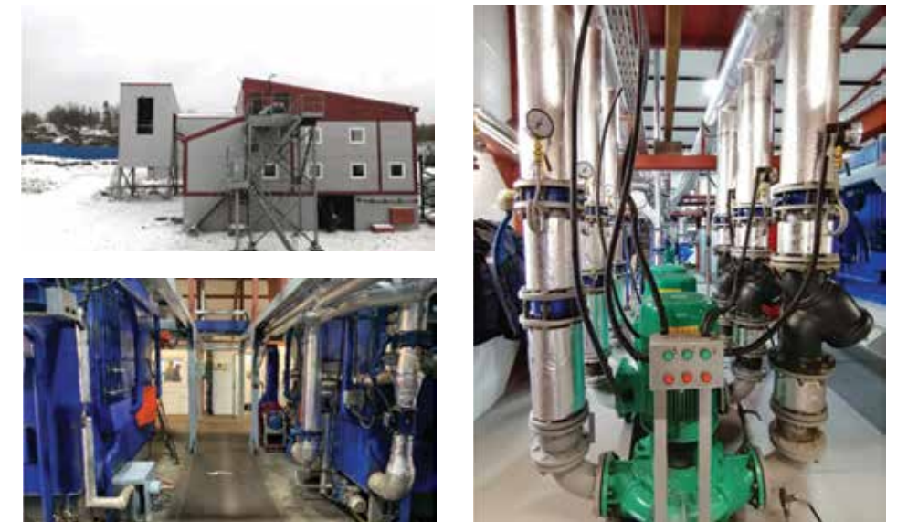
Рис. 1. Блочная котельная установка мощностью 5 МВт на базе двух котлов КВм-2,5 КБ, каменный/бурый уголь. Республика Саха (Якутия)
