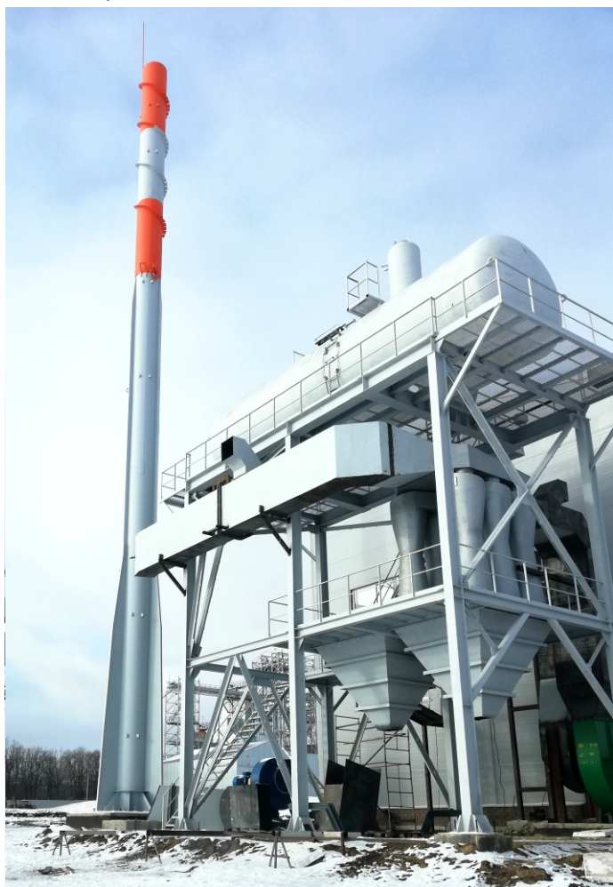
Фото 7 — Котельная с паровыми котлами ДЕ 25-1,4 и Е-20-1,4, основное топливо — лузга подсолнечника, резервное — природный газ, Воронежская область
