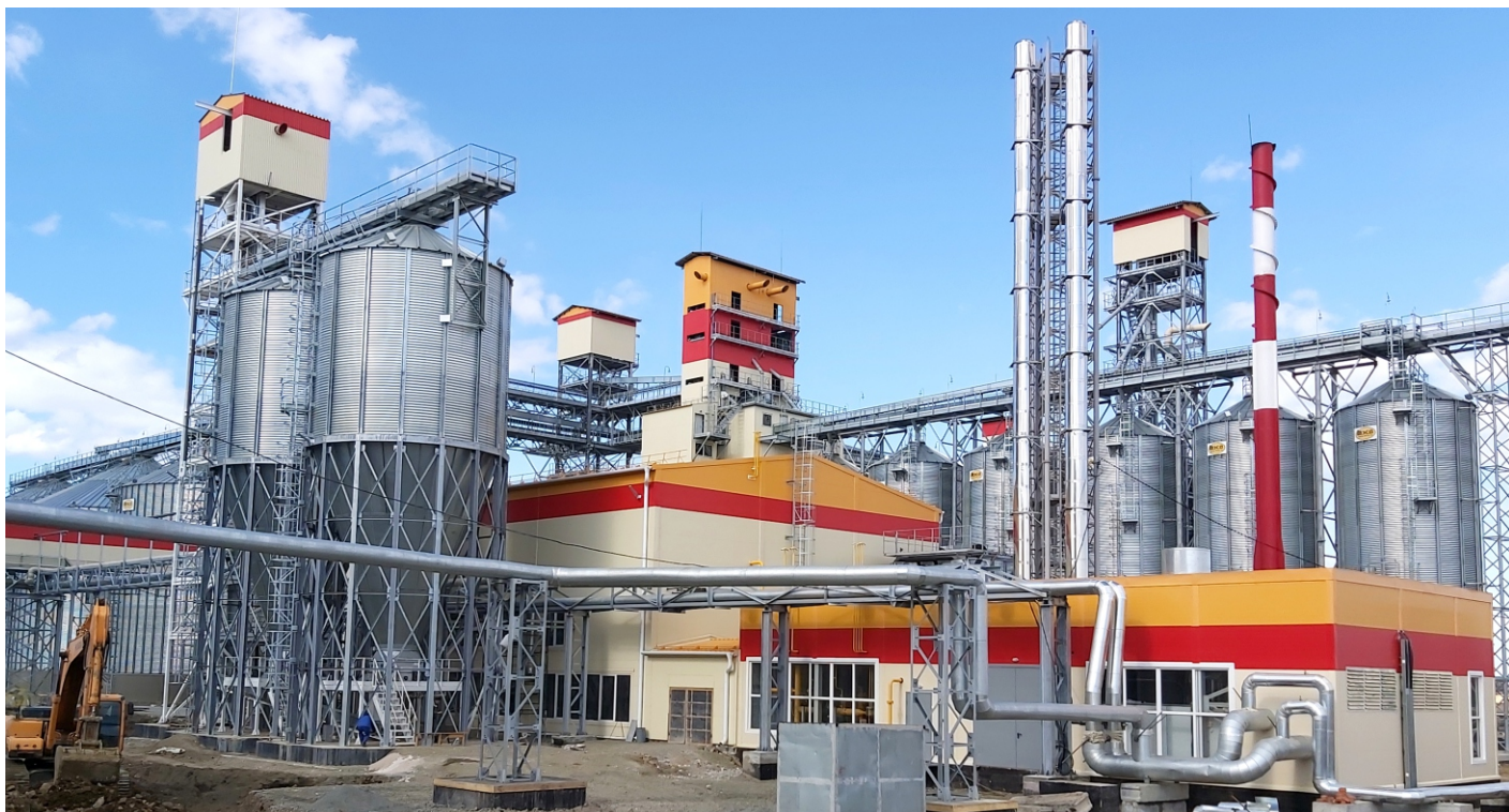
Фото 6 — Паровая котельная с котлом Е-10-1,4 ОИ, основное топливо — лузга овса, резервное топливо — природный газ, Челябинская область
