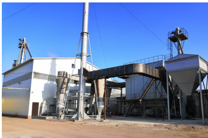
Фото 9 — Паровая котельная с двумя котлами Е- 6,5-1,4, основное топливо — лузга подсолнечника, резервное топливо — природный газ, Самарская область
