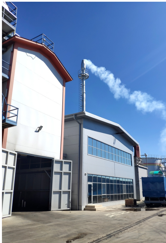
Фото 5 — Паровая котельная с котлом Е-10-1,4-300 ОИ на лузге подсолнечника, республика Адыгея
