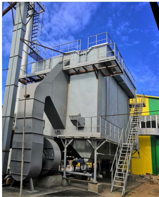
Фото 2 — Фильтр очистки газов паровой котельной с двумя котлами Е-6,5-1,4 на лузге подсолнечника, Самарская область
