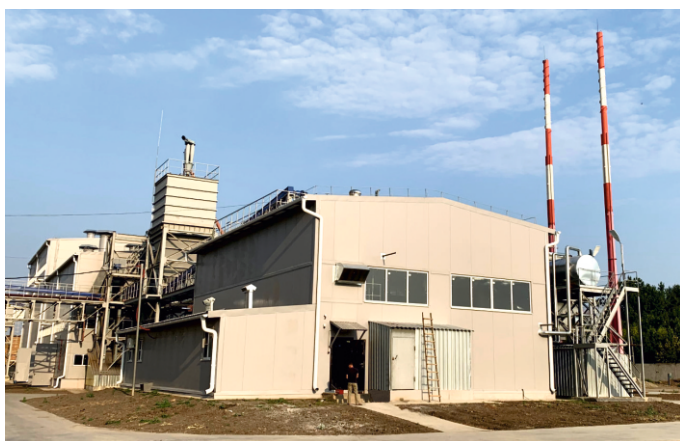
Фото 4 — Паровая котельная с двумя котлами Е-4-1,4 на лузге подсолнечника, Краснодарский край
